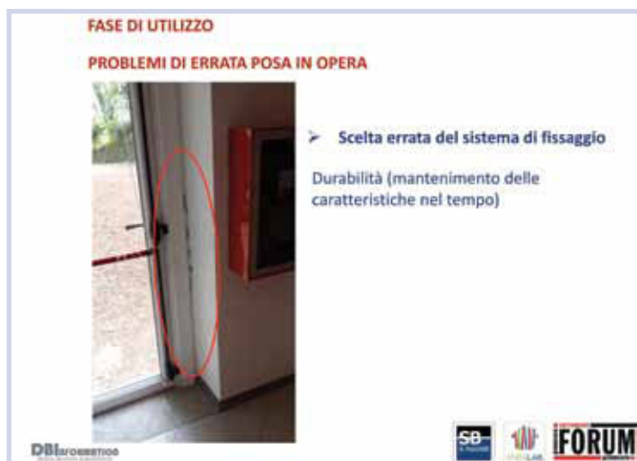
Esempio di errata posa in opera (fissaggio) (dalla relazione di Luca Papili, Studio Botta, Enerlab).
